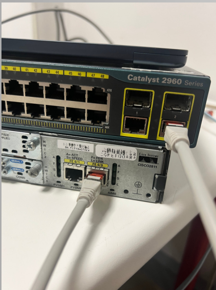
Branchement du switch au routeur
